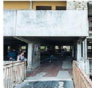
Il sopralluogo L'allarme è scattato il 22 giugno scorso dopo l'intervento dei vigili
