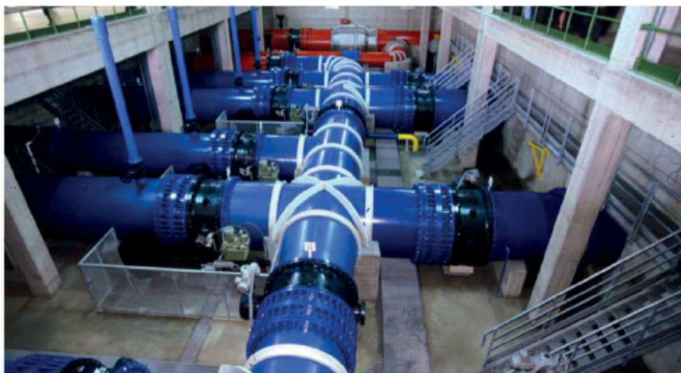
Un impianto. Condotte dell'Arin, società del comune di Napoli, che finora gestisce i servizi idrici
