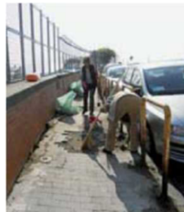
Belvedere Resta la pavimentazione a pezzi
