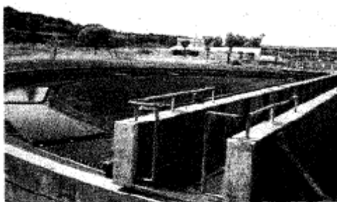
L'impianto Il depuratore di Cuma, da anni al centro di polemiche
